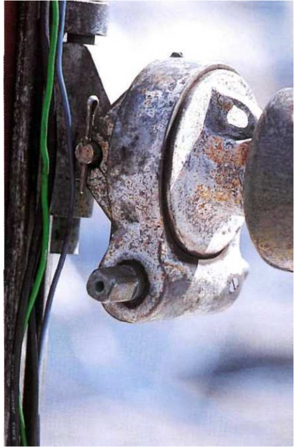
Вертлюг подвергается износу и деформации
