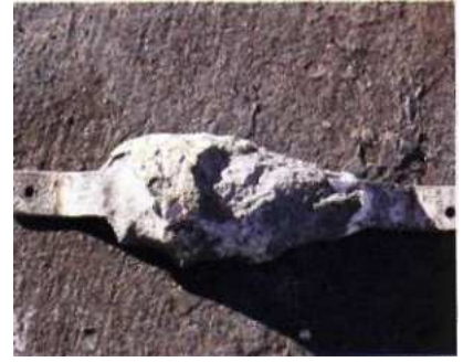
Анод, разрушенный коррозией
